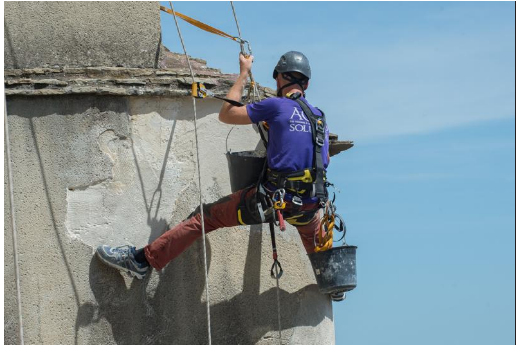
Jeudi, au château de Montbéliard. Le crépi part en lambeaux sur les fortifications. Acro Solution effectue une reprise à la chaux. Photo ER/Christian LEMONTEY
